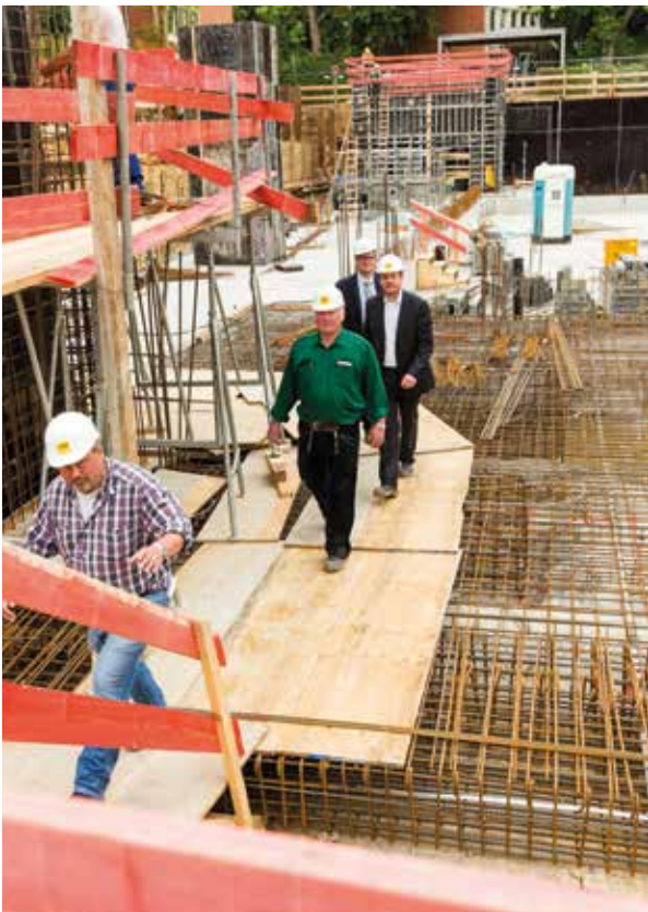
Das Team des Generalunternehmers Züblin sorgt für die fristgerechte Umsetzung der Pläne
